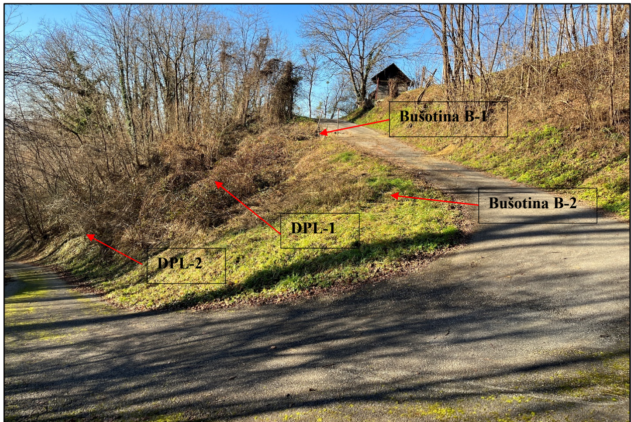
Slika 3. Prikaz zatečenog stanja klizišta (nestabilne klizne padine i istražnih bušotina)
