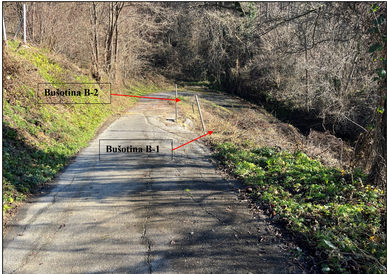
Slika 2. Prikaz zatečenog stanja klizišta na nerazvrstanoj cesti u naselju Kamenjak, Mala ulica
